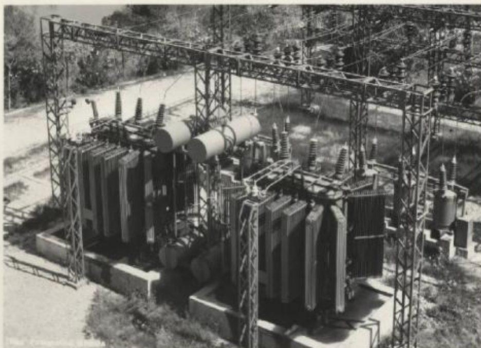
27. Anno 1943 - Società Romana di Elettricità - Impianto Alto Melfa 2 trasformatori trifasi 6.500 kVA - 8.000-9.000/78.916-81.839 V - 50 Hz.
