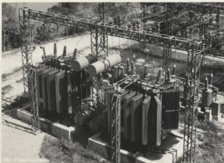
27. Anno 1943 - Società Romana di Elettricità - Impianto Alto Melfa 2 trasformatori trifasi 6.500 kVA - 8.000-9.000/78.916-81.839 V - 50 Hz
