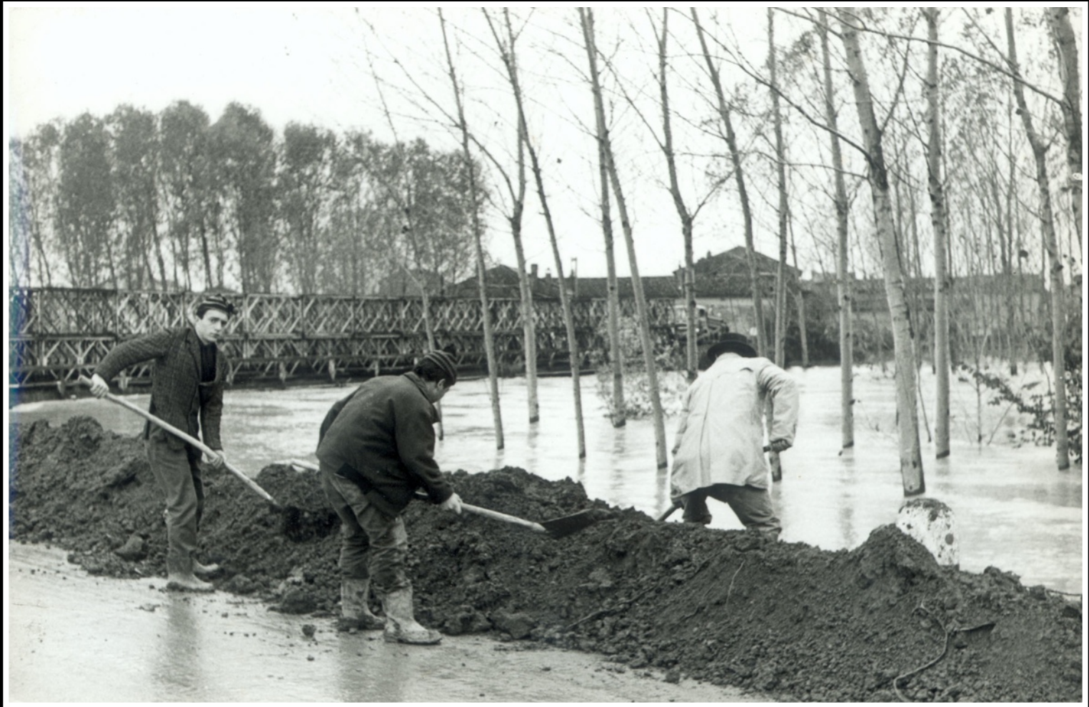
Bizzolano - Alluvione - Fiume Chiese - Ponte - Rinforzo dell'argine Foto Dante Bellamio, 06.11.1966, GBO_3438
